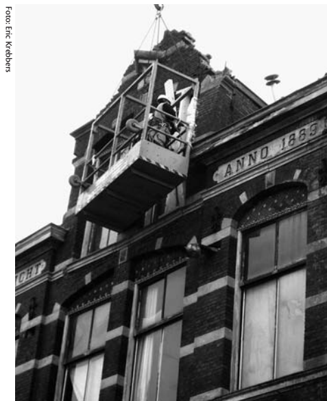
Noodreparatie in 2008 om instortingsgevaar bij pand Koppenhinksteeg 2 te voorkomen.
